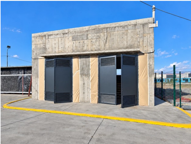
Conjunto de portones y elementos de ventilación.
