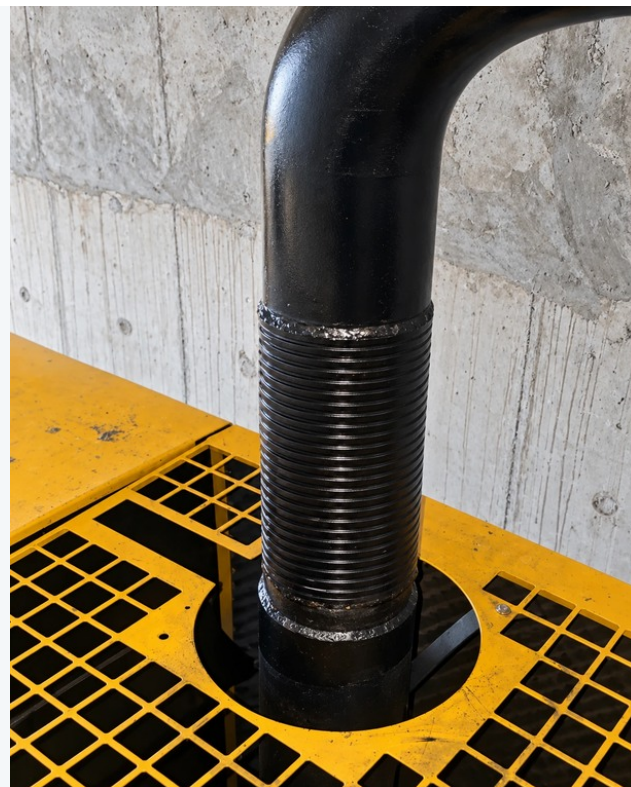
Unión flexible y conexión al equipo.
